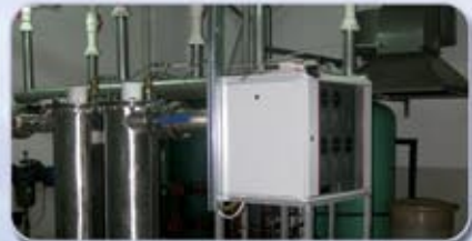
Установка ЭЛИЗ, производительностью 50 м³/ч на заводе Kraft Foods Inc, г. Тростянец, Сумская область.
