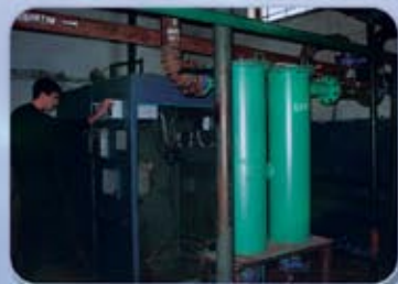
Установка БАУ производительностью 100 м³/ч на котельной ГП «Донецкая железная дорога»
