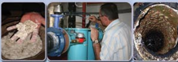
Чистка и характер осаждения накипи на реакторах установки БАУ на котельной Центрально-городской больницы г. Харцызска, Донецкая область.
