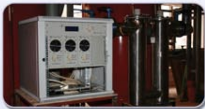
Установка БАУ производительностью 50 м³/ч на котельной торгового комплекса «ДонецкСити»
